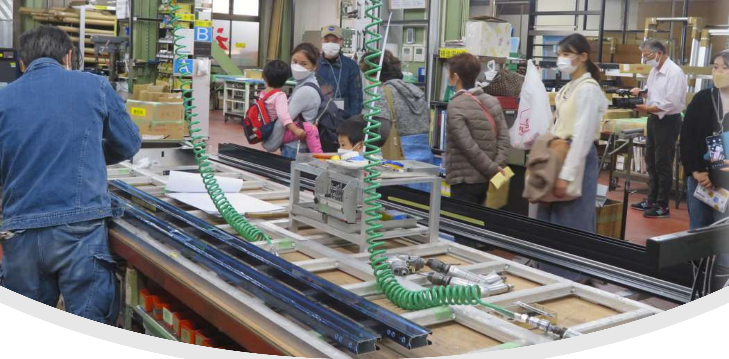
注文の窓サッシを設計図に沿って製作しているところ
